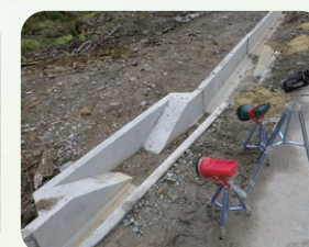
小動物の這い出し側溝
