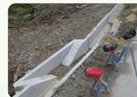
小動物の這い出し側溝
