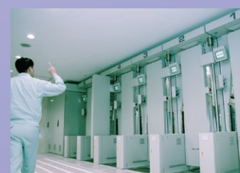
体表面ゲートモニタの点検
