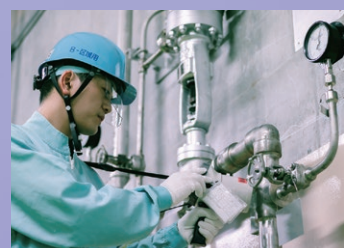
配管の放射線量測定
